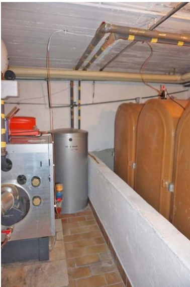
Zentralheizung und Öltanks
