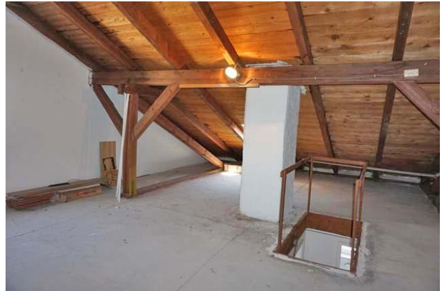
Viel Platz im Speicher
