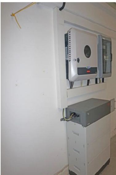
Eigener Strom - PV-Anlage mit Speicher
