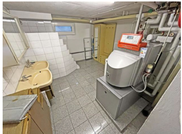
Heizraum und hinten Dusche
