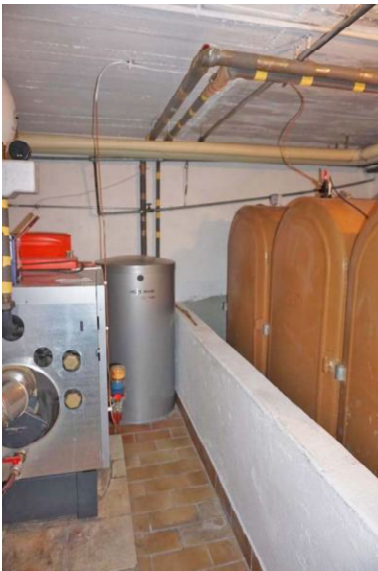
Zentralheizung und Öltanks
