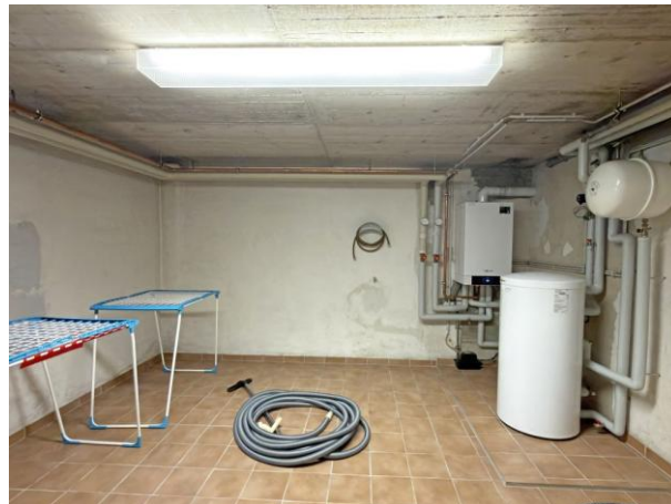
Heiz-/Trockenraum und Zentralstaubsauganlage
